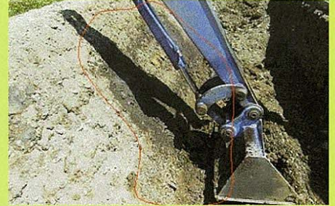
バックホーの作動油のホースが破裂して、内法面上に漏れた状況。
