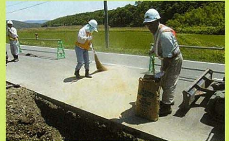
舗装に漏れた作動油に現場で備蓄していたオイルゲーターを撒き、油吸着させている状況。
