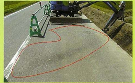
バックホーの作動油のホースが破裂して、舗装の上に漏れている。
